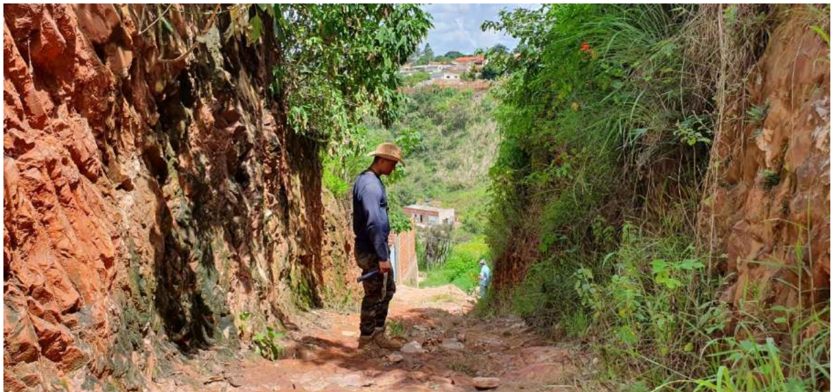
Figura 31 - Pontos 60/61 Campanha 1. Exemplo de ocupação urbana em área com declividade maior que 30%. A elevada declividade do terreno requereu a instalação de um profundo corte de talude para acesso à área.
